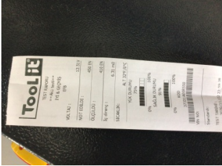
Elektrik donanımı/Pano, Akü > Test Sonucu
