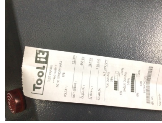
Elektrik donanımı/Pano, Akü > Test Sonucu
