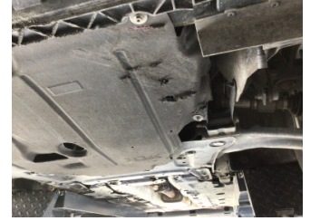
Motor, Alt muhafaza > Hasarlı
