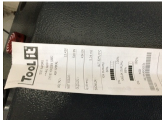
Elektrik donanımı/Pano, Akü > Test Sonucu
