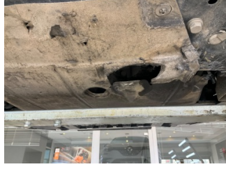
Motor, Alt muhafaza > Hasarlı
