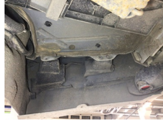
Tampon, arka, Bağlantı ayağı > Hasarlı
