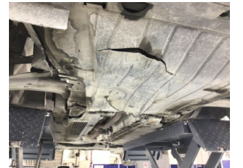
Motor, Alt muhafaza > Hasarlı
