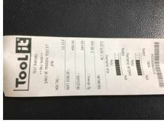
Elektrik donanımı/Pano, Akü > Test Sonucu
