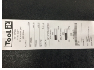
Elektrik donanımı/Pano, Akü > Test Sonucu
