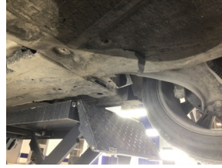
Motor, Alt muhafaza > Deforme Olmuş
