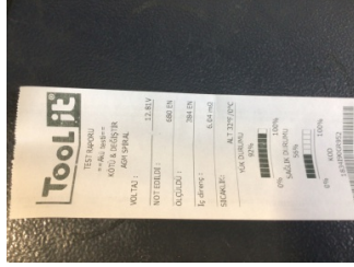
Elektrik donanımı/Pano, Akü > Test Sonucu
