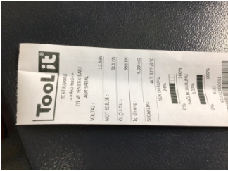
Elektrik donanımı/Pano, Akü > Test Sonucu
