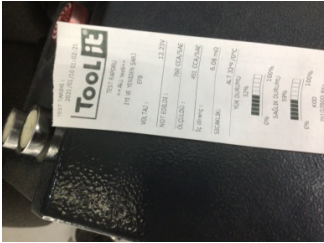
Elektrik donanımı/Pano, Akü > Test Sonucu
