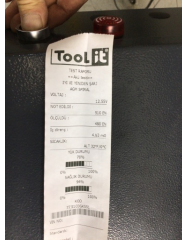
Elektrik donanımı/Pano, Akü > Test Sonucu
