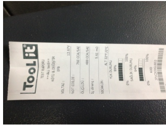
Elektrik donanımı/Pano, Akü > Test Sonucu
