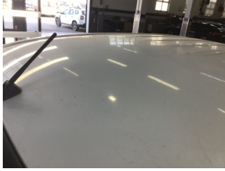
Tavan, Tavan > Dolu Hasarı
