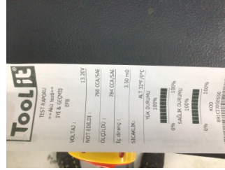
Elektrik donanımı/Pano, Akü > Test Sonucu
