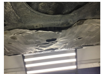
Motor, Alt muhafaza > Hasarlı
