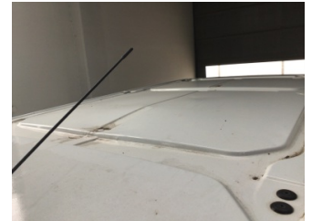
Tavan, Tavan > Hasarlı
