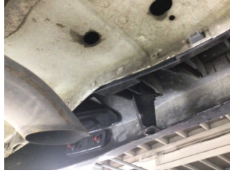
Tampon, arka, Bağlantı ayağı > Hasarlı
