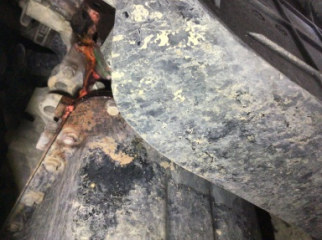
Motorsoğutması, Su pompası > Sızdırıyor
