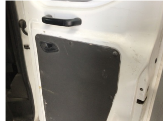
Döşemeler/Kapaklar, Döşemeler/Kapaklar > Çizik
