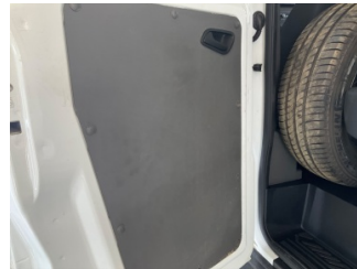
Döşemeler/Kapaklar, Döşemeler/Kapaklar > Kirlenmiş
