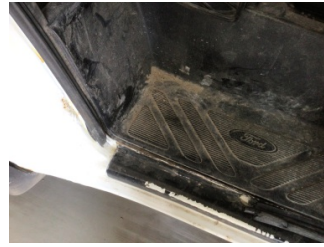
Kapı, sol ön, Kapı fitili > Deforme Olmuş
