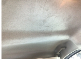
Döşemeler/Kapaklar, Döşemeler/Kapaklar > Deforme Olmuş
