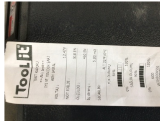
Elektrik donanımı/Pano, Akü > Test Sonucu
