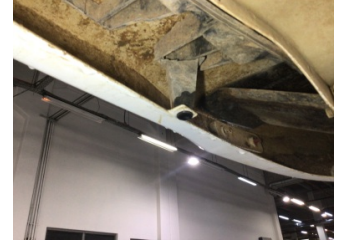
Tampon, arka, Bağlantı ayağı > Hasarlı
