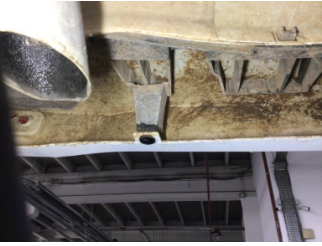
Tampon, arka, Bağlantı ayağı > Hasarlı
