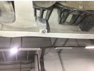
Tampon, arka, Bağlantı ayağı > Hasarlı
