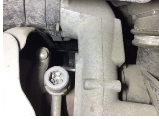
Motor, Motor üst kapağı, plastik > Yağ Kaçağı
