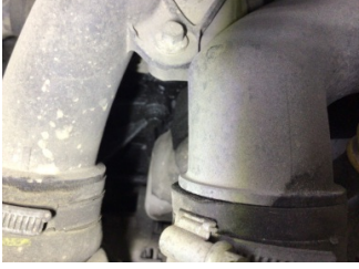
Motor, Motor üst kapağı, plastik > Yağ Kaçağı
