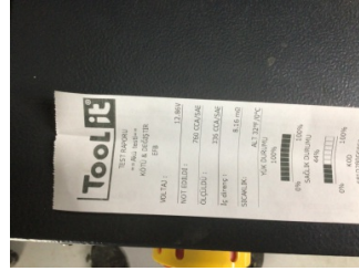
Elektrik donanımı/Pano, Akü > Test Sonucu
