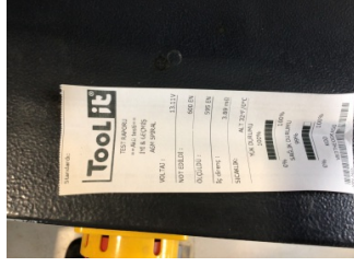
Elektrik donanımı/Pano, Akü > Test Sonucu
