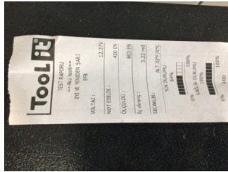
Elektrik donanımı/Pano, Akü > Test Sonucu
