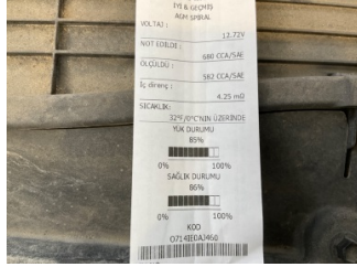
Elektrik donanımı/Pano, Akü > Test Sonucu
