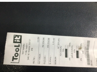
Elektrik donanımı/Pano, Akü > Test Sonucu
