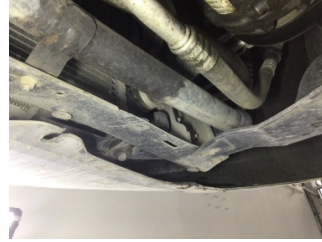
İlave parçalar, ön, Ön koruma demiri - bağlantı ayağı > Hasarlı
