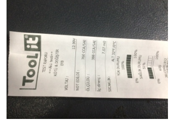
Elektrik donanımı/Pano, Akü > Test Sonucu
