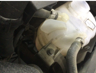
Motorsoğutması, Soğutma sıvısı > Eksik
