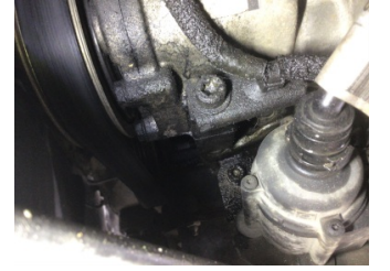
Kalorifer/Klima, Klima kompresörü > Yağ Kaçağı
