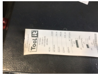
Elektrik donanımı/Pano, Akü > Test Sonucu
