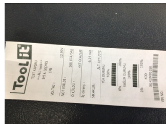
Elektrik donanımı/Pano, Akü > Test Sonucu
