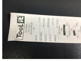
Elektrik donanımı/Pano, Akü > Test Sonucu
