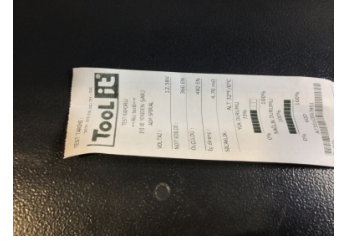
Elektrik donanımı/Pano, Akü > Test Sonucu
