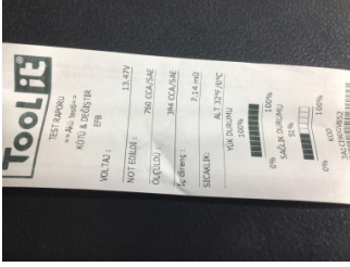
Elektrik donanımı/Pano, Akü > Test Sonucu
