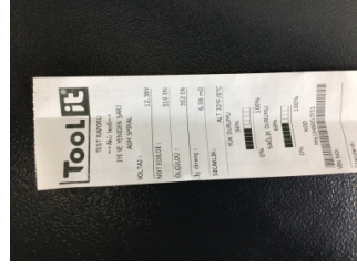
Elektrik donanımı/Pano, Akü > Test Sonucu
