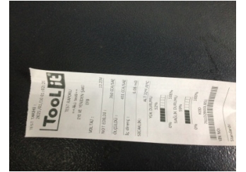
Elektrik donanımı/Pano, Akü > Test Sonucu
