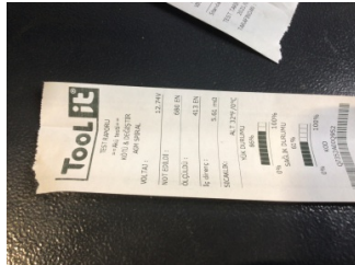
Elektrik donanımı/Pano, Akü > Test Sonucu
