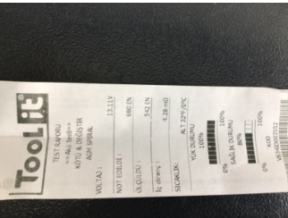
Elektrik donanımı/Pano, Akü > Test Sonucu
