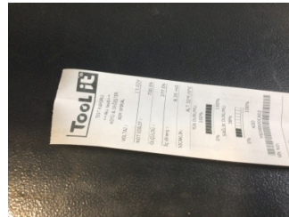
Elektrik donanımı/Pano, Akü > Test Sonucu
