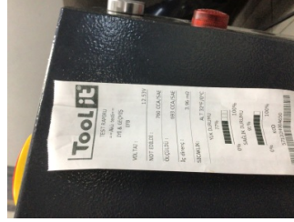
Elektrik donanımı/Pano, Akü > Test Sonucu
