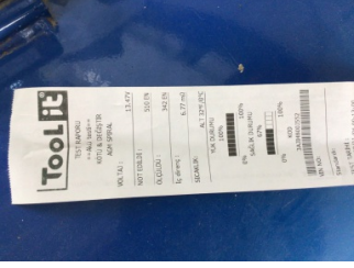
Elektrik donanımı/Pano, Akü > Test Sonucu
