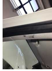
Döşemeler/Kapaklar, Tavan döşemesi > Kirlenmiş
