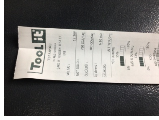
Elektrik donanımı/Pano, Akü > Test Sonucu
